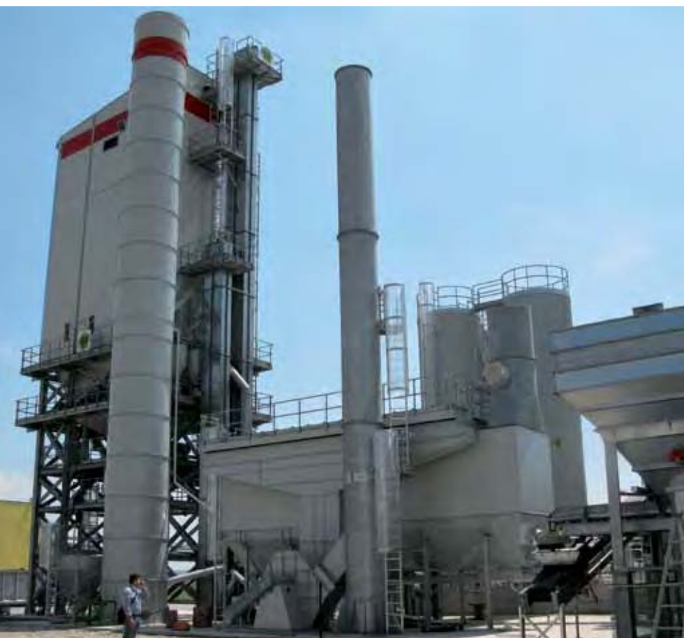
Impianto produzione asfalti - cortesia di Bernardi Impianti
