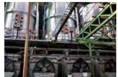
Impianto chimico - filtri a tamburo
